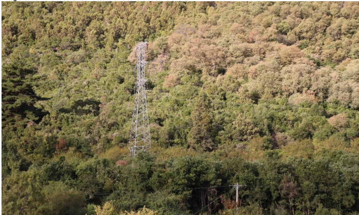
Fotografía N°6: Torre de transmisión eléctrica en la comuna de San Clemente
