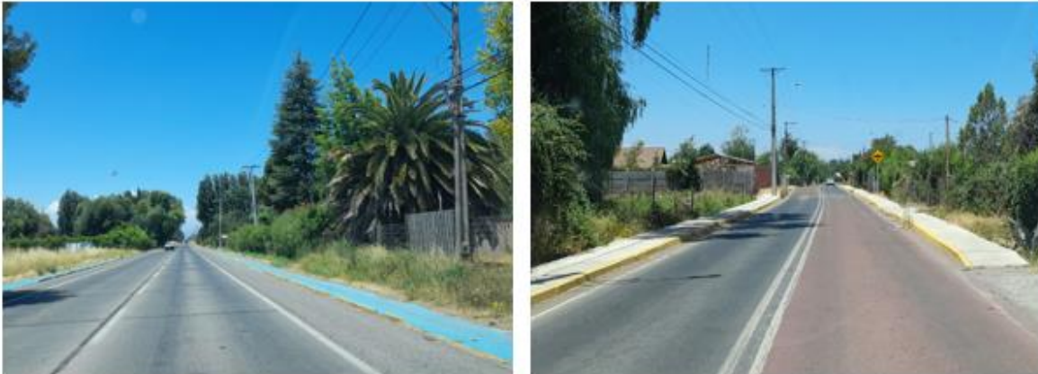
Ilustración 26 y 27: Ciclovía en ruta J-60 y obras de veredas y seguridad vial en la ruta J-470 sector El Llano.
