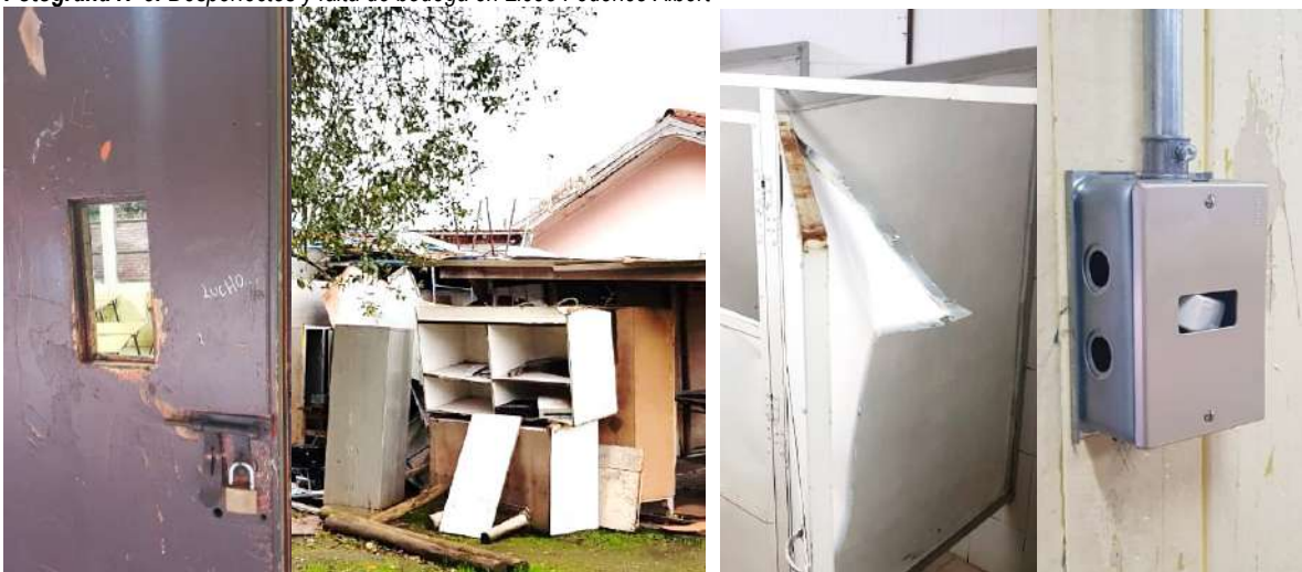
Fotografía N°5: Desperfectos y falta de bodega en Liceo Federico Albert
