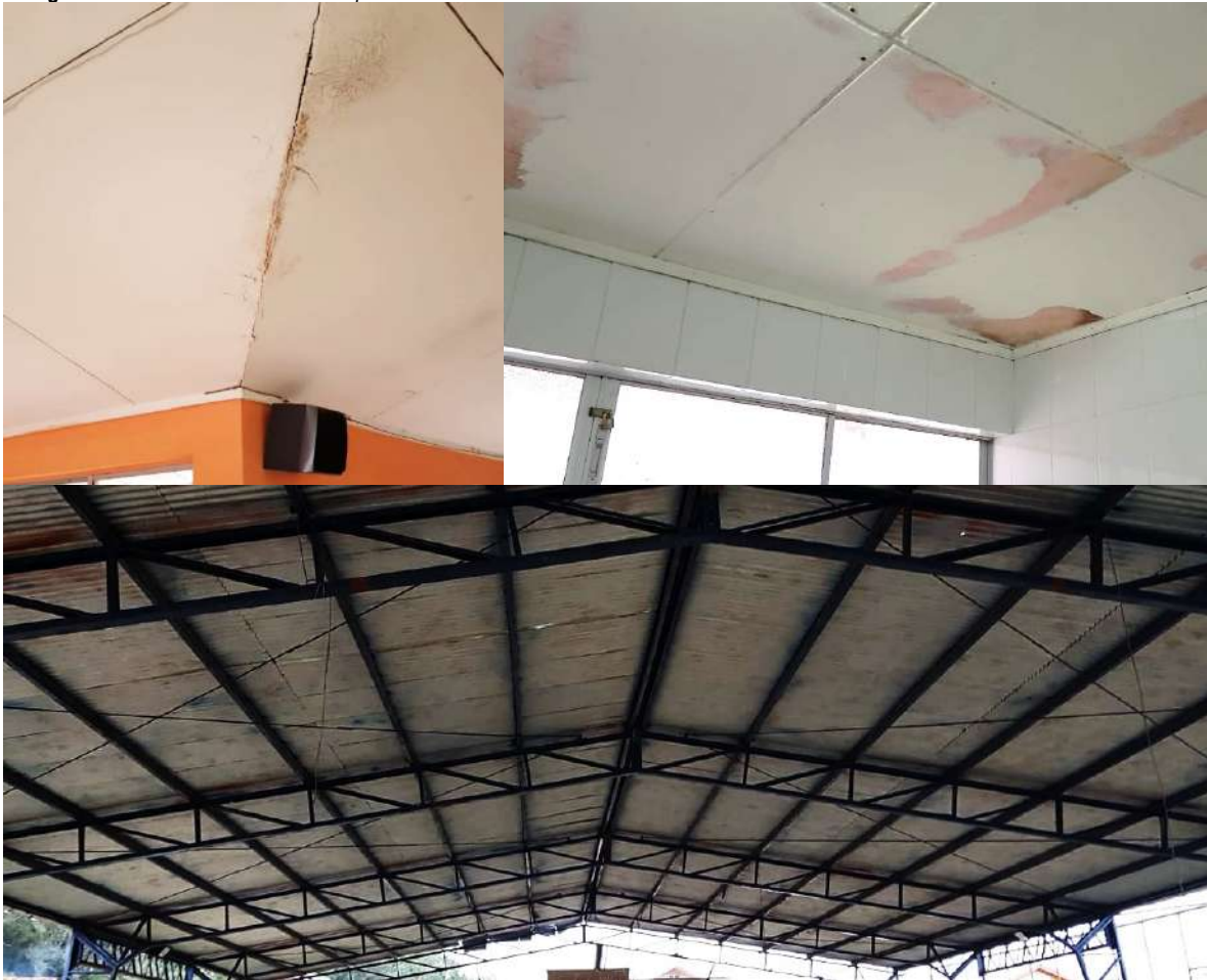
Fotografía N°6: Zonas en mal estado que se llueven en el Liceo Federico Albert
