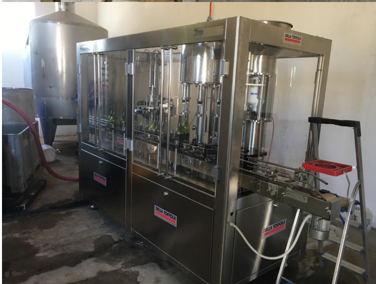
Vista a espacio habilitado, cubas, montacarga. En imagen inferior se observa embotelladora adquirida.
