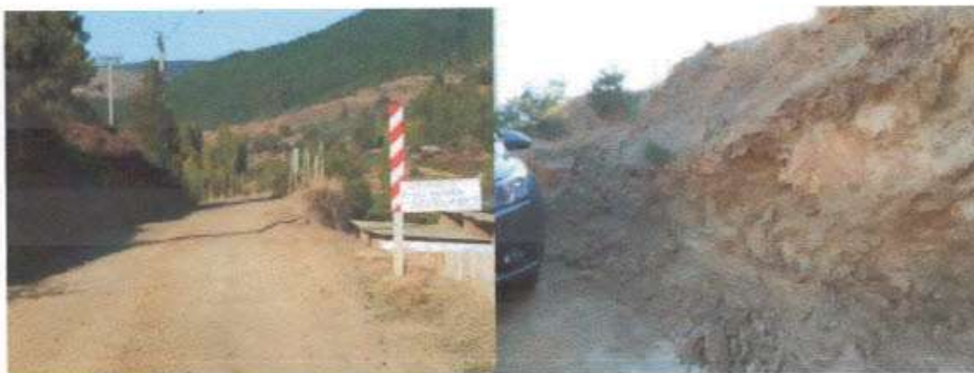
FIGURA N° 4-20 A) Sector en el extremo sur de la vía Cancha Rayada. Talud (izquierda de la imagen) donde permanentemente ocurren caídas de bloques. Corresponde a la unidad del basamento metamórfico meteorizado. B) Basamento metamórfico meteorizado en sector sur de Cancha Rayada
